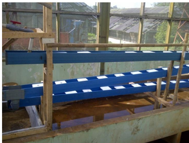
Gambar 1. Bangunan hidroponik NFT yang digunakan
