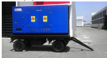
Gambar 9. Genset Gardu Induk. Sumber : PT. PLN (Persero) , 2010.
